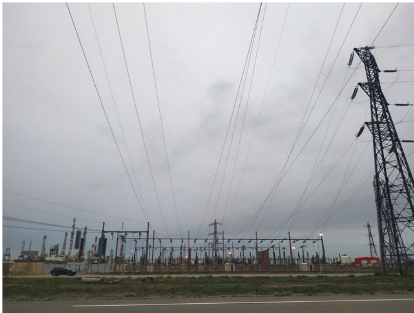
Le poste RTE de 225 KV qui alimenterait H2V Fos Marseille pour la première phase
